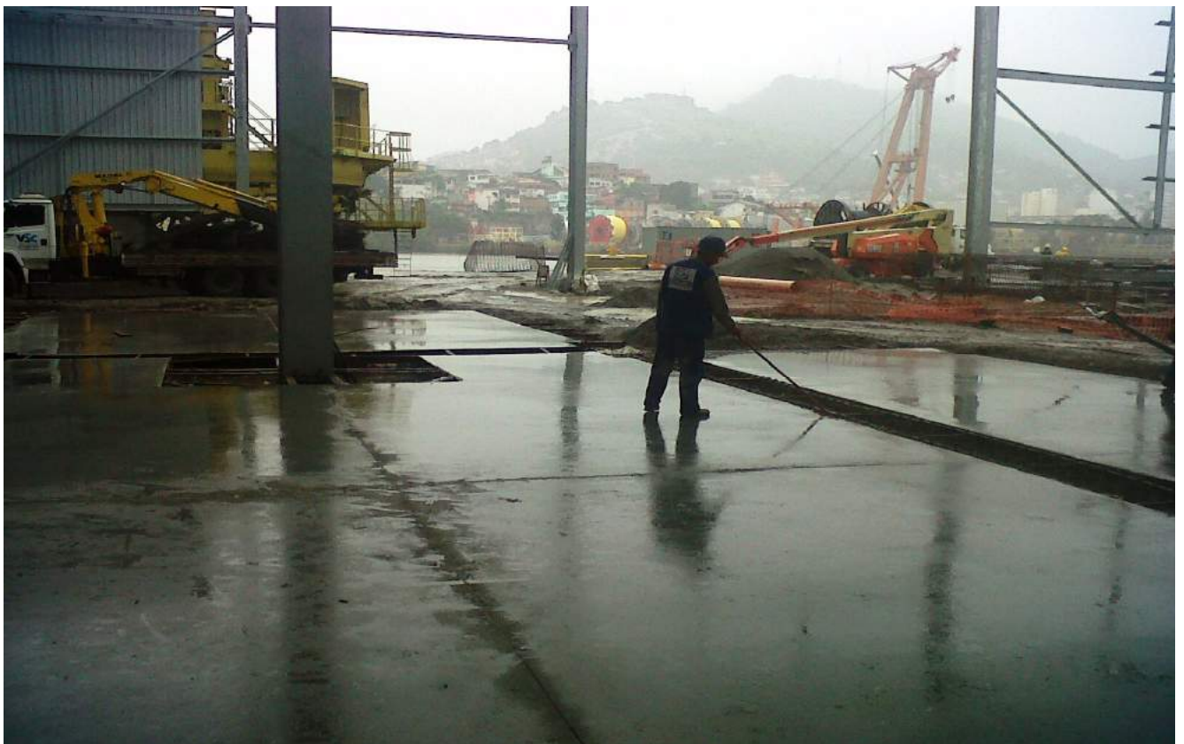
Recalque diferencial da fundação após 10 meses
